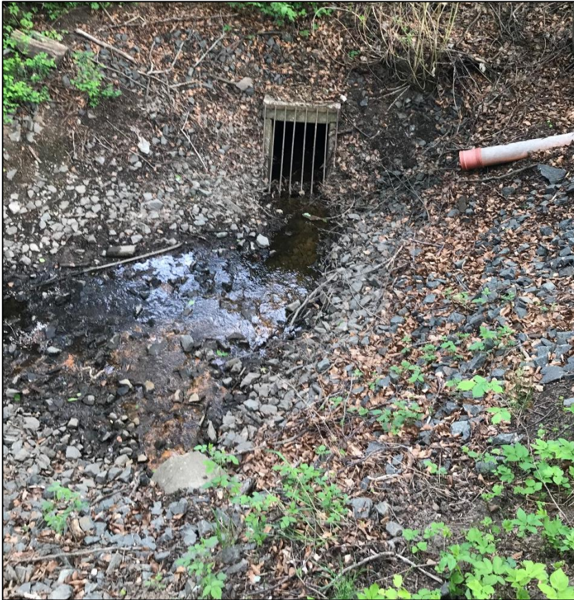
Figur 6. Stenkulvert belägen i det instängda parkområdet och PVC-rör som avvattnar parkering ca 30 m väster om området
